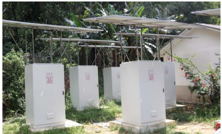
Sebahagian daripada sistem fotovolt suria (PV) yang telah selesai dipasang
