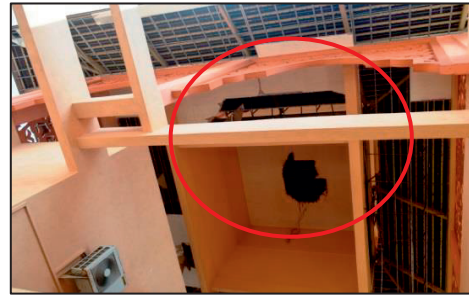
PB Square - Siling Pecah dan Rosak (17.02.2021) (Sumber: Jabatan Audit Negara)
