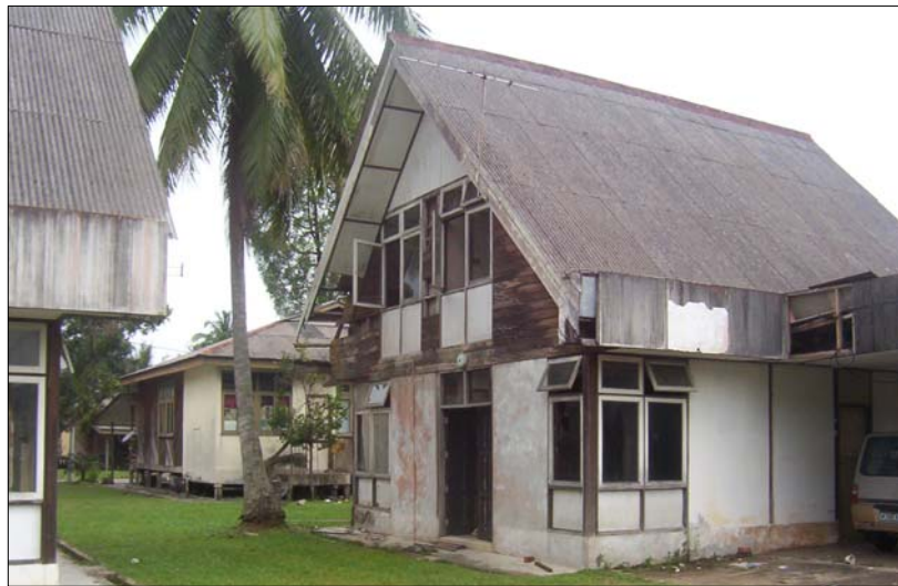
Foto 21 Rumah Usang Akibat Tidak Disenggara Dengan Baik Berlaku Pembaziran
