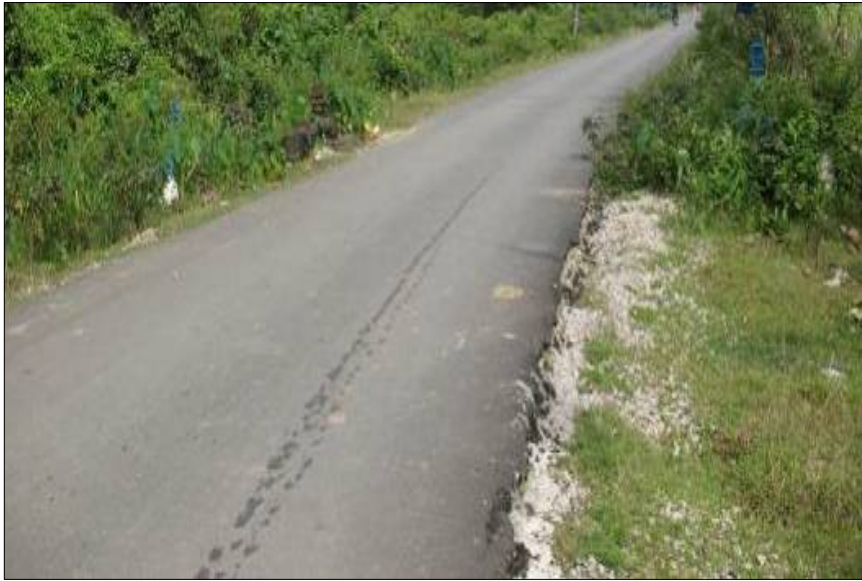
Foto 63 Bahu Jalan Yang Bertebing Tinggi
