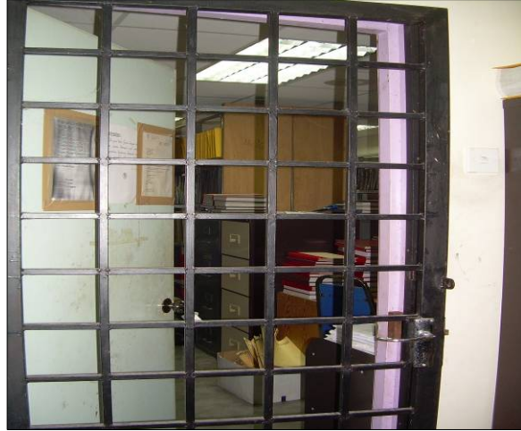
Foto 87 Pintu Bilik Fail Tambahan Tidak Kalis Api
