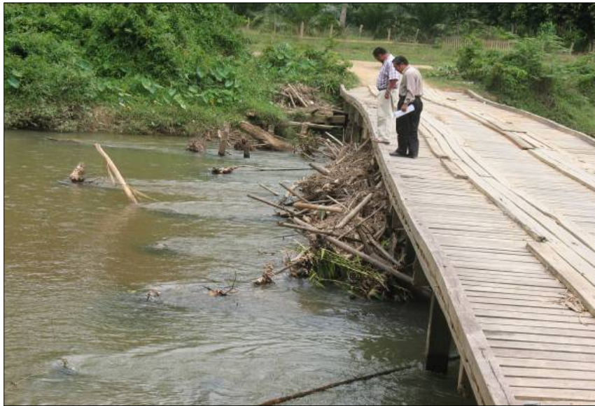
Foto 67 Kayu, Buluh Dan Sampah Sarap Yang Tersangkut Pada Jambatan
