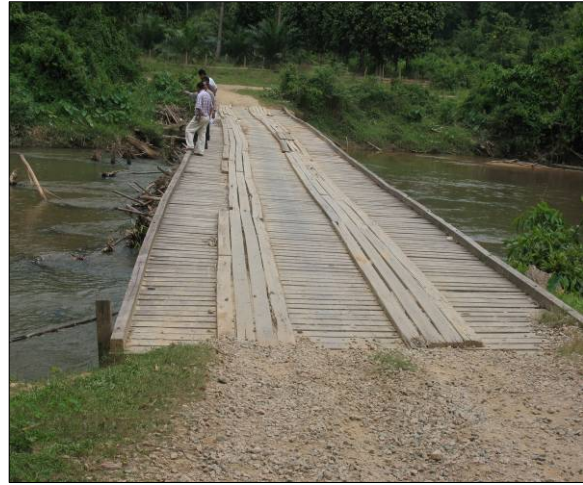
Foto 69 Kayu Pada Jambatan Separuh Konkrit Ada Yang Telah Tertanggal
