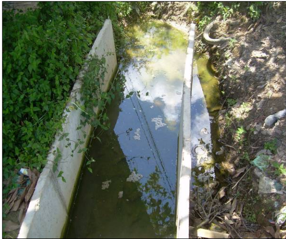
Foto 34 Longkang Yang Tidak Ada Aliran Air Keluar
