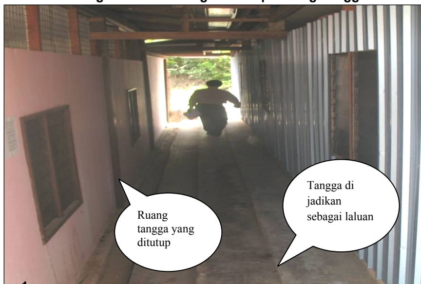
Foto 102 Ruang Tambahan Yang Menutupi Ruang Tangga
