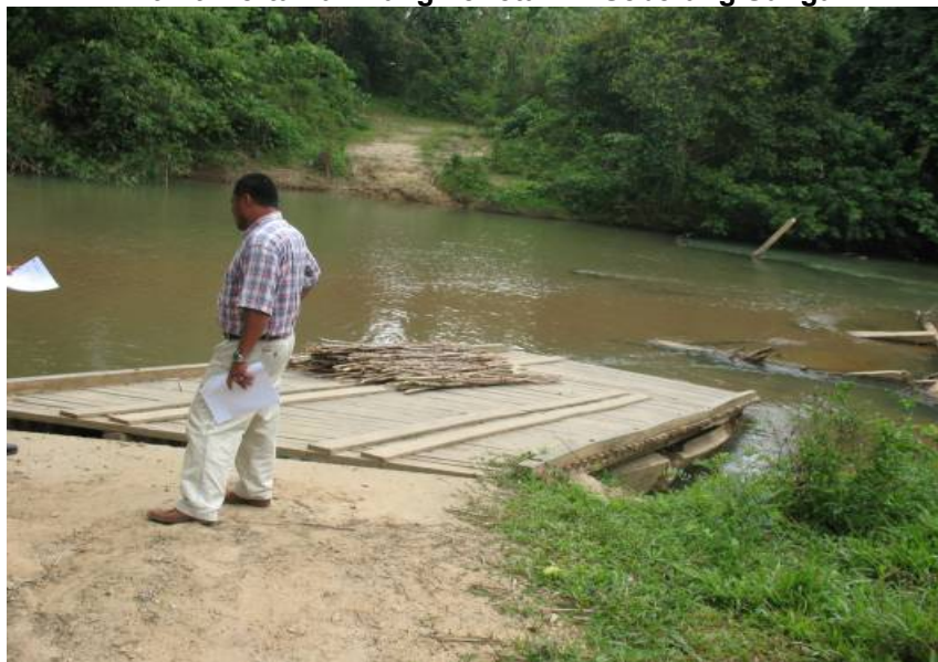
Foto 73 Kerosakan Jambatan Menyukarkan Penduduk Ke Kawasan Aktiviti Pertanian Yang Terletak Di Seberang Sungai
