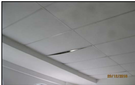
Bangunan Kedai/Pejabat Blok C, Pekan Ajil - Siling Melendut (20.12.2016)
