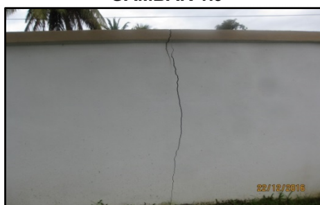
Masjid Kg. Darat, Batu Rakit - Rekahan di Dinding Pagar (22.12.2016)
