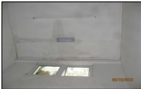
Bangunan Kedai/Pejabat Blok C, Pekan Ajil - Bumbung Bocor Menyebabkan Kesan Air di Siling (20.12.2016)
