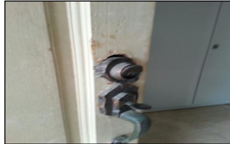
Hotel Ruane-TATI, Terengganu - Kunci Pintu Rosak (17.12.2016)
