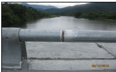
Jambatan Kg. Dusun, Hulu Terengganu - Hand Railing Berkarat (20.12.2016)
