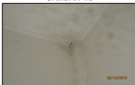
Masjid Kg. Darat, Batu Rakit - Bumbung Bocor Menyebabkan Kesan Air di Siling (22.12.2016)
