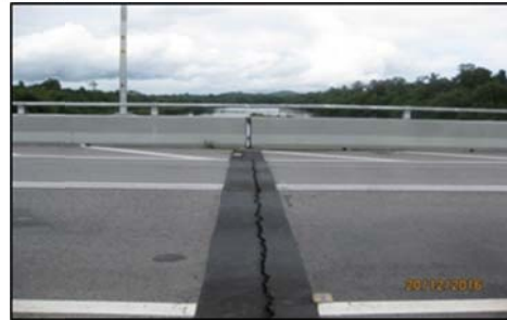
Jambatan Kg. Dusun, Hulu Terengganu - Jalan Retak (20.12.2016)
