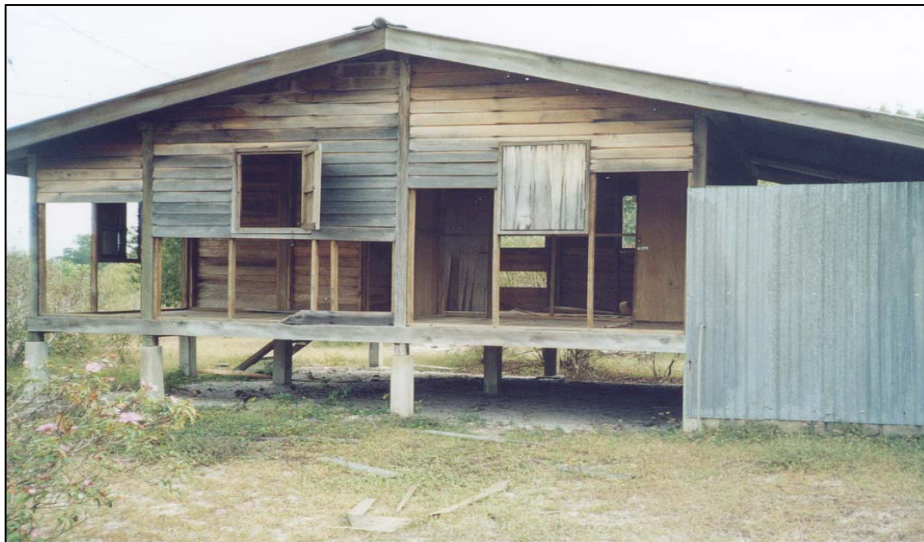
Foto 1 Keadaan Rumah Rosak Di Rhu Tapai
