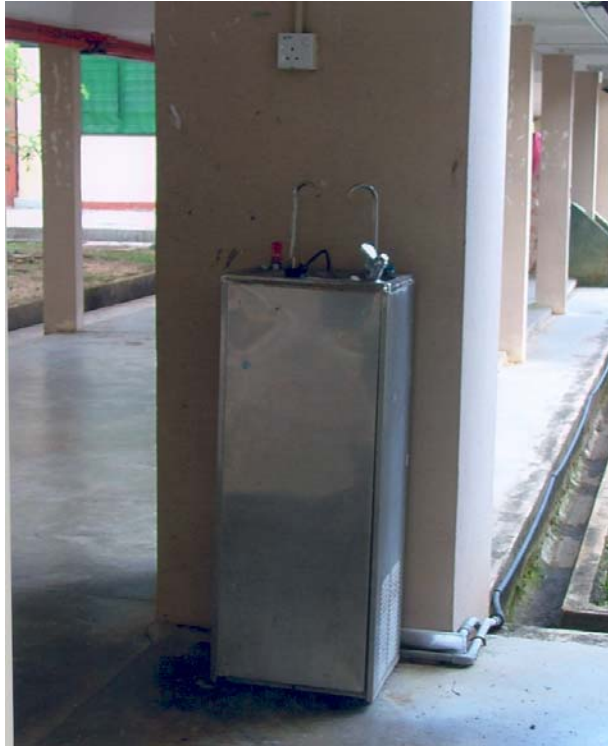
Foto 5 Water Cooler Yang Rosak Dan Tidak Boleh Digunakan
