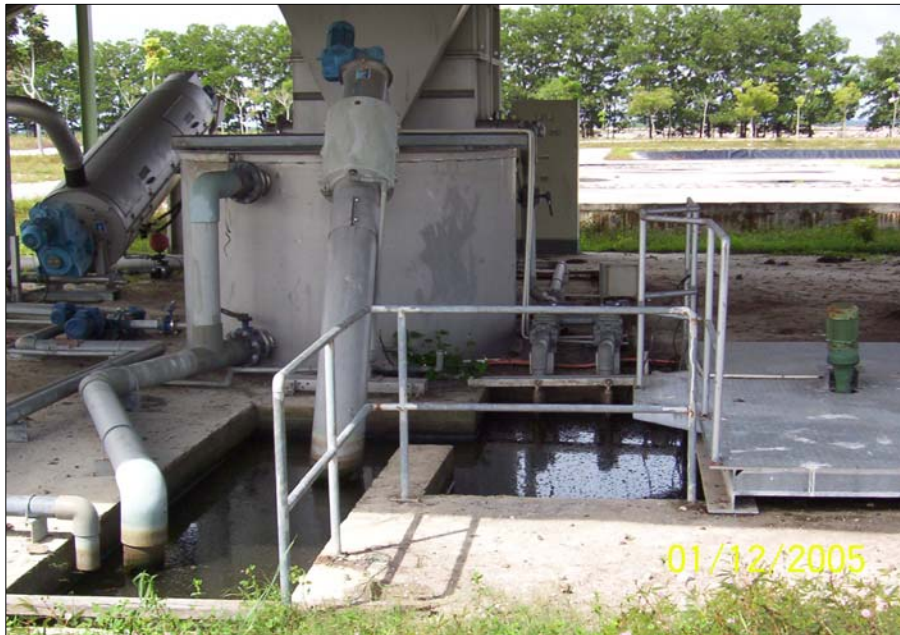
Sumber: Fail Foto Jabatan Audit Negara Cawangan Selangor Lokasi : Kompleks Rumah Sembelih, Batang Berjuntai, Kuala Selangor
