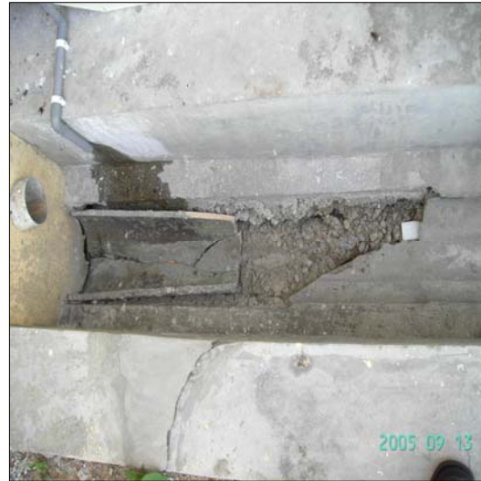
Foto 4 Longkang Pecah Di Bangunan Utama
