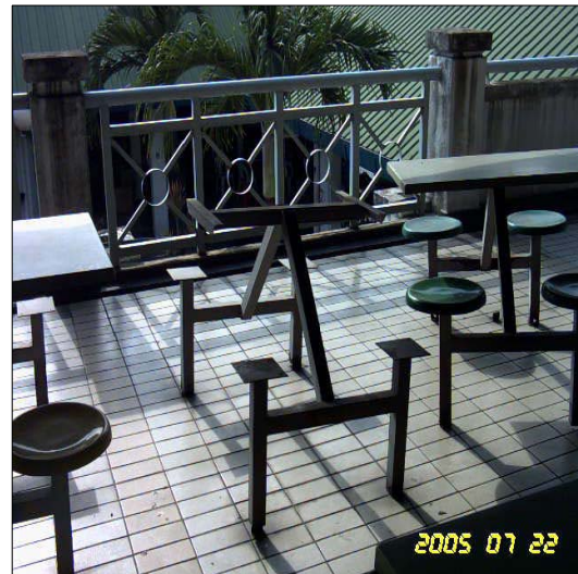
Foto 43 Kerosakan Pada Perkakasan Di Gerai Makan Pasar Besar Jalan Meru
