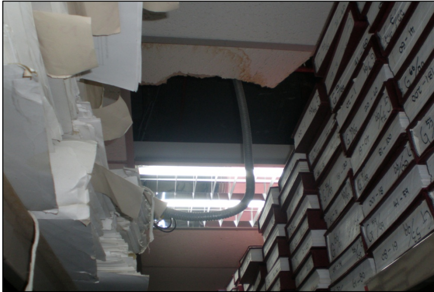
Foto 24 Kebocoran Siling Di Bilik Kebal Di PTGS
