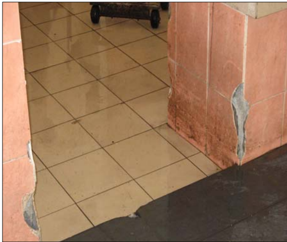
Tiles Dinding Yang Pecah
