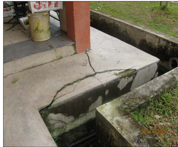
Struktur Longkang Yang Retak
