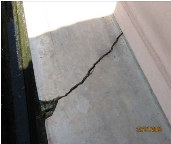
Foto 139 Keretakan Di Lantai Pasar
