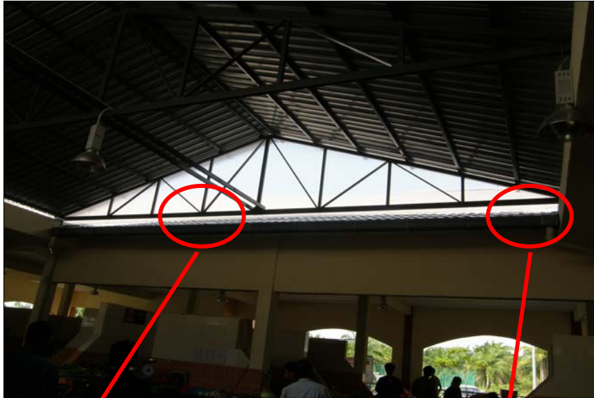
Foto 128 Gutter Yang Mengalami Masalah Tempias
