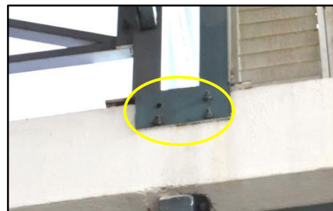
Gerai Fasa Satu, Taman Greenwood - Pemasangan Skru pada Plat Keluli Struktur Kekuda Bumbung Tidak Sempurna (09.05.2017)
