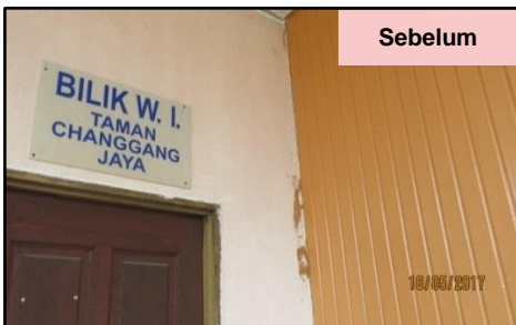
Balai Raya Taman Changgang Jaya, Bukit Changgang, Kuala Langat - Cat Dinding Tidak Kemas (18.05.2017)
