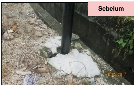
Pasar Awam Sungai Jarom dan Medan Selera Sungai Jarom, Kuala Langat - Asas Binaan Tiang Papan Tanda Tidak Kukuh (18.05.2017)
