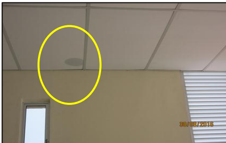
Pasar Awam, Pekan Hulu Yam Baharu - Kesan Resapan Air pada Siling (30.08.2016)
