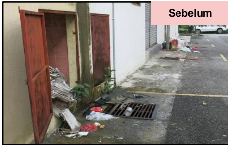
Taman Mutiara, Tanjung Sepat - Lorong Belakang Lot Premis Tidak Dibersihkan (15.05.2017)
