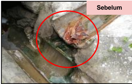
Jalan Wira 20 & 26, Taman Perwira, Telok Panglima Garang - Pemasangan Longkang Tidak Kemas (22.05.2017)
