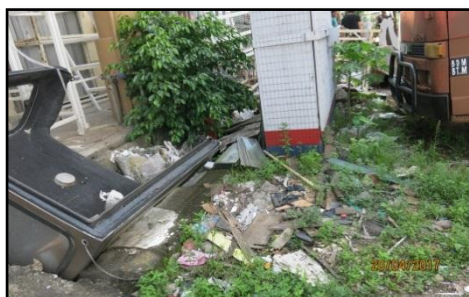
Taman Industri KIP (Komersial) - Longkang yang Tidak Dibersihkan dan Tersumbat (20.04.2017)
