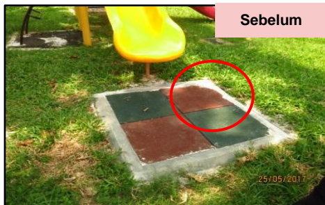
Jalan Semilang 5, Taman Seri Putra, Banting - Kerja Lepaan Simen di Sekeliling Rubber Mat Tidak Kemas (25.05.2017)
