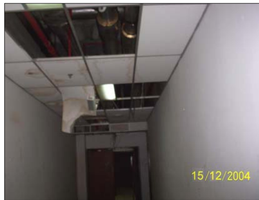
Foto 21 Keadaan Siling Yang Rosak Di Ruang Laluan Stor Koleksi
