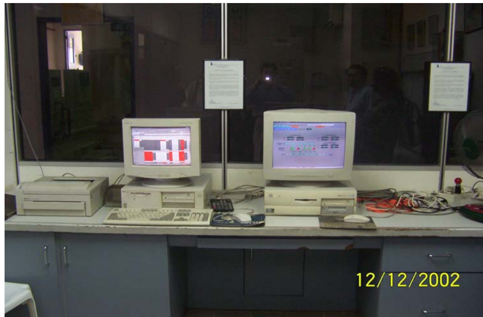
Foto 2 Sistem Kawalan Berkomputer Di Loji Rawatan Air Moyog, Kota Kinabalu
