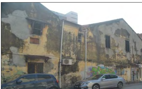
Lebuhraya Gereja - Cat Dinding Bangunan Yang Usang (06.07.2017)
