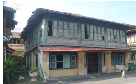
Lebuhraya Aceh - Bangunan Yang Telah Rosak Dan Tidak Dibaik Pulih (05.07.2017)
