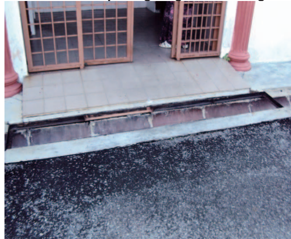
Gambar 6.20 Besi Penutup Longkang Telah Hilang
