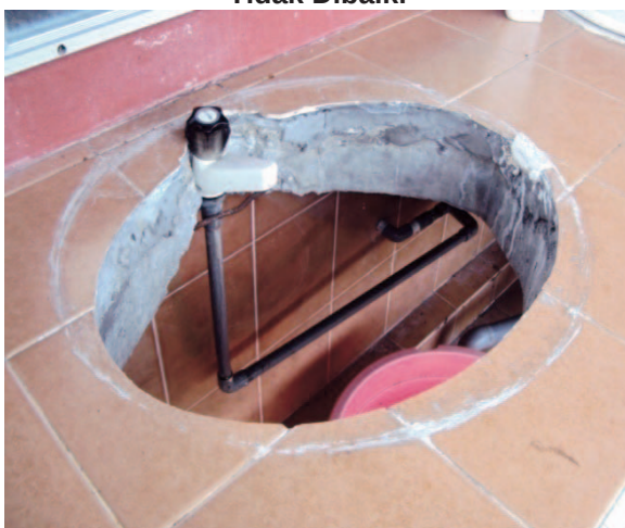
Gambar 6.17 Sinki Untuk Kegunaan Pelanggan Yang Tidak Dibaiki
