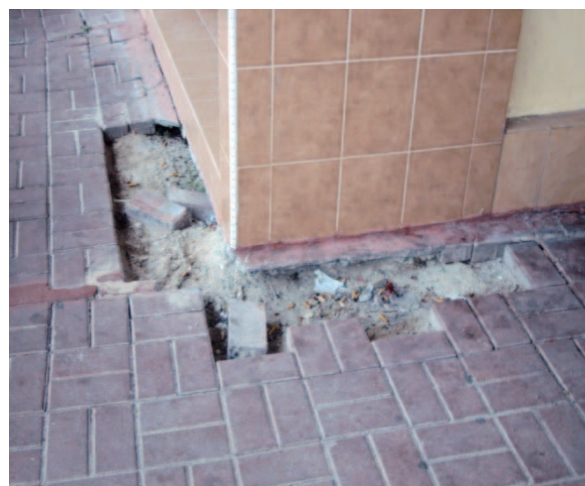
Gambar 6.18 Interlocking Yang Telah Rosak
