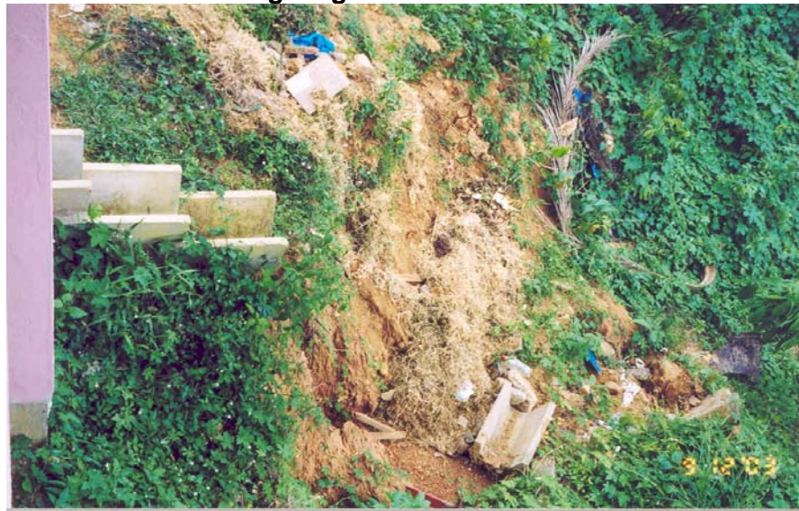
Foto 13 Longkang Pecah Akibat Hakisan
