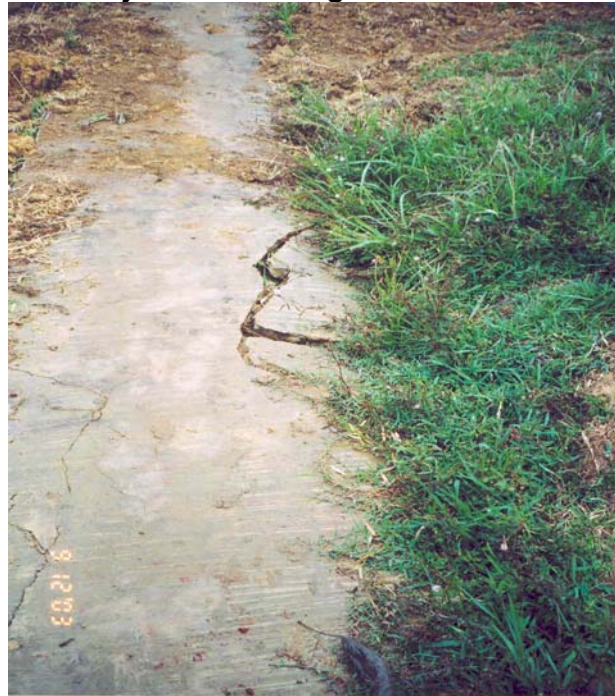
Foto 12 Laluan Pejalan Kaki Yang Telah Retak Dan Pecah
