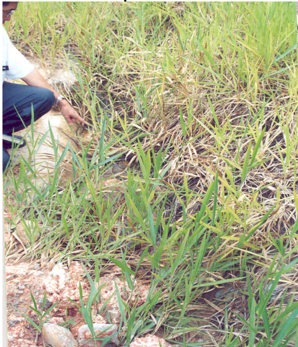
Foto 3 Bench Drain Tersumbat Dan Ditumbuhi Rumput Di Jalan A CH 150
