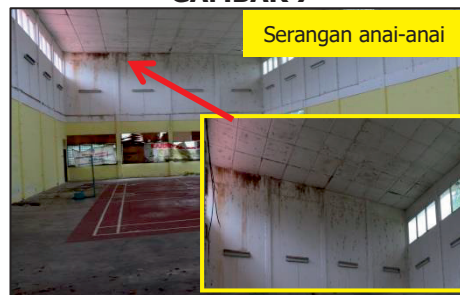
Kerja Baik Pulih Atap Dewan Kampung Jambu, Pekan - Keadaan Siling Dewan yang Diserang Anai-anai (17.09.2020) (Sumber: Jabatan Audit Negara)
