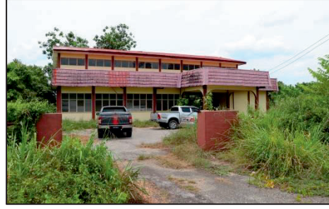
Kerja Baik Pulih Atap Dewan Kampung Jambu, Pekan - Keadaan Persekitaran Dewan Dipenuhi Semak Samun (17.09.2020) (Sumber: Jabatan Audit Negara)
