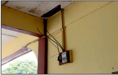
Kerja Baik Pulih Atap Dewan Kampung Jambu, Pekan - Kecurian Wayar Elektrik (17.09.2020) (Sumber: Jabatan Audit Negara)
