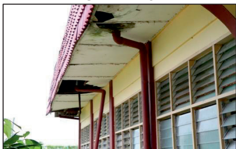
Kerja Baik Pulih Atap Dewan Kampung Jambu, Pekan - Keadaan Siling Bangunan Rosak dan Pecah (17.09.2020) (Sumber: Jabatan Audit Negara)
