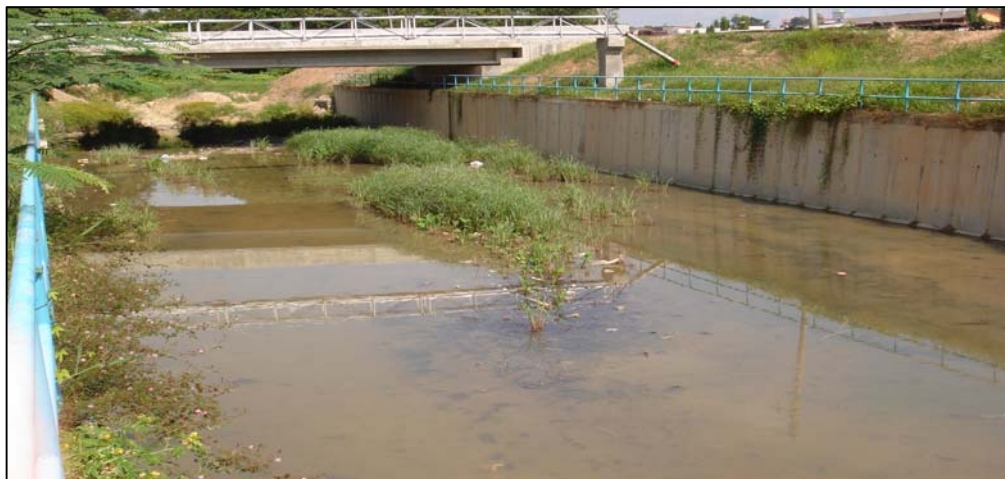
Sumber: Foto Jabatan Audit Negara Tarikh: 18 April 2006 Lokasi : RTB Pekan Gemas Fasa 2
