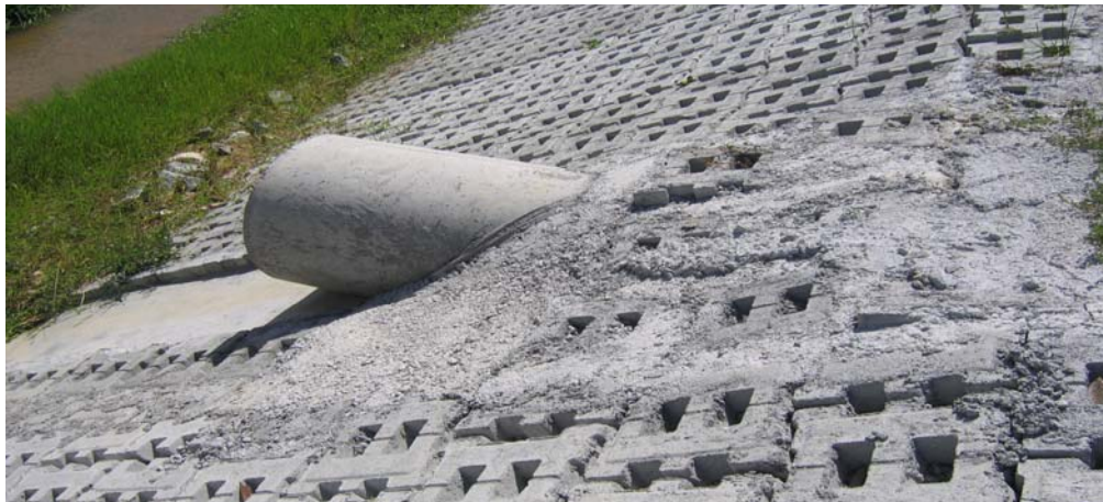
Foto 10 Pelindung Cerun Patah Dan Dilepa Atau Ditampal Dengan Simen
