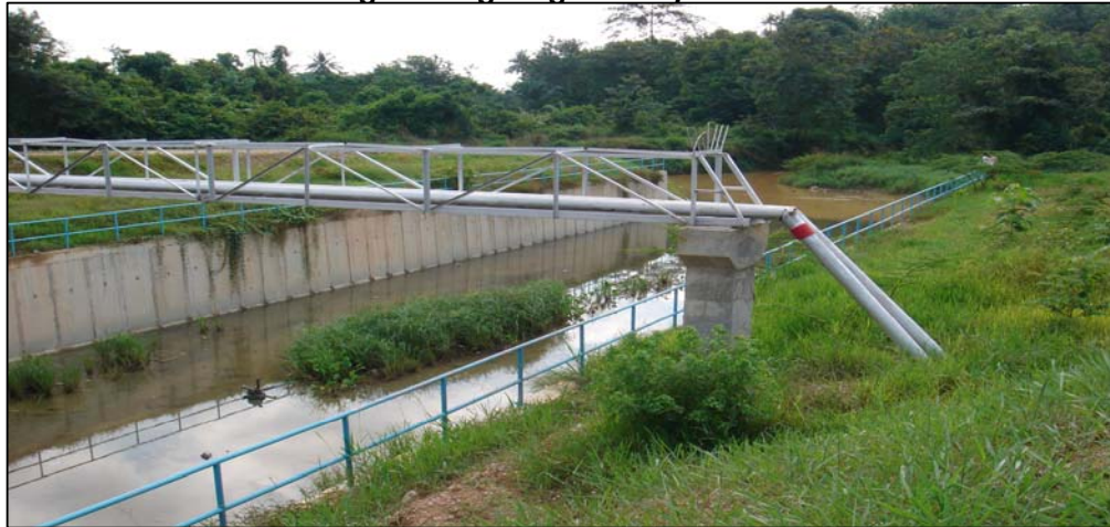
Sumber: Foto Jabatan Audit Negara Tarikh : 18 April 2006 Lokasi : RTB Pekan Gemas Fasa 2
