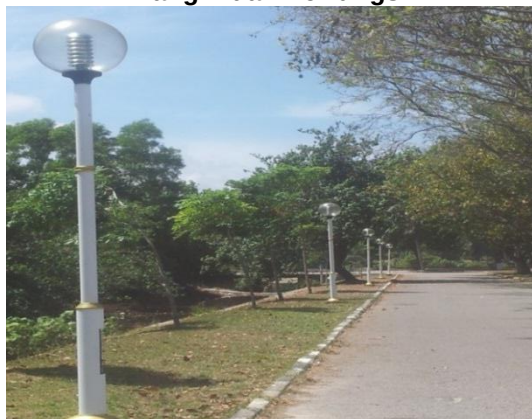
Gambar 1.9 Sebahagian Lampu Deco Globe Yang Tidak Berfungsi
