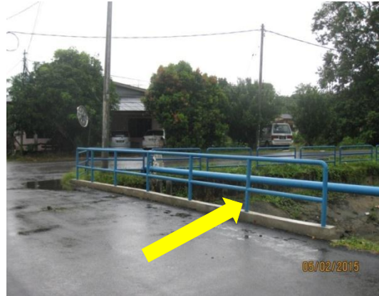
Gambar 2.9 Reka Bentuk Pagar Jambatan Yang Dibina Tidak Mengikut Lukisan Pelan
