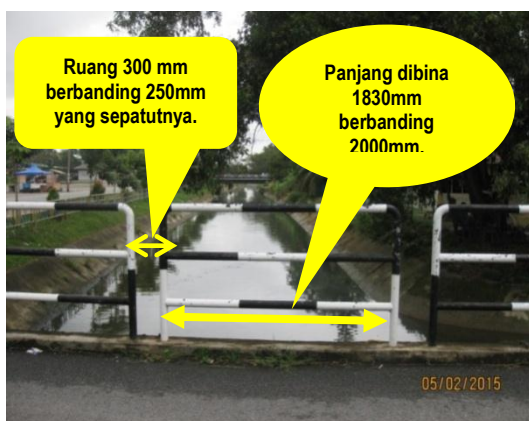
Gambar 2.7 Pembinaan Tidak Mengikut Spesifikasi Pelan
