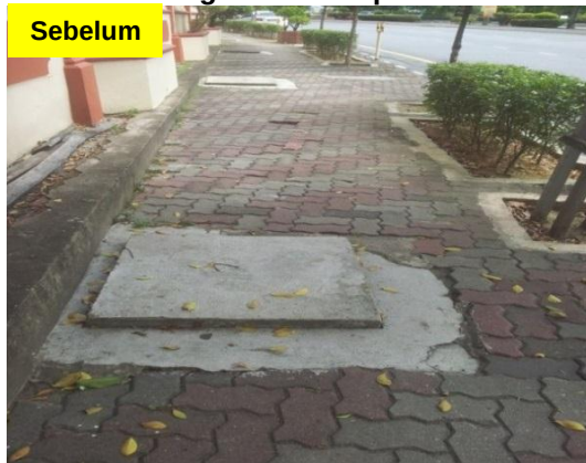
Gambar 1.24 Pembinaan Penutup Manhole Yang Tidak Sempurna
