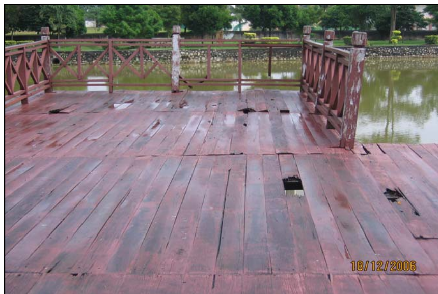
Foto 41 Pelantar Kayu Di Tasik Y Telah Rosak Dan Tidak Selamat
