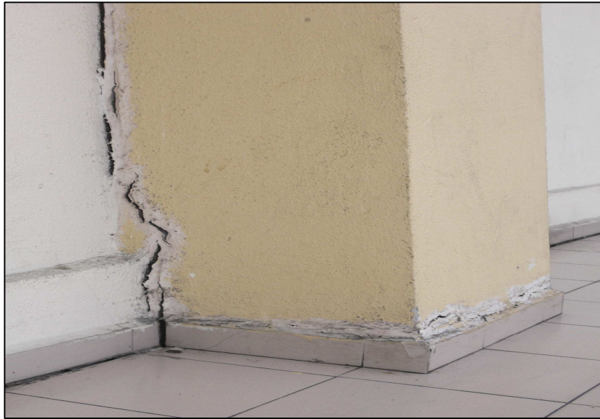
Foto 11 Keretakan Pada Salah Satu Tiang Ruang Menunggu
