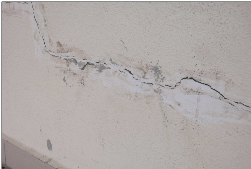
Foto 14 Keretakan Pada Dinding Terminal Yang Ditutup Dengan Filler
