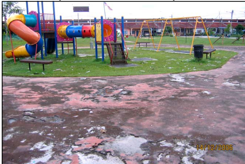
Foto 44 Laluan Pejalan Kaki Rosak Dan Tiada Kerja Pembaikan
