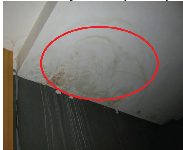
Foto 8.4 Kerosakan Siling Akibat Resapan Air Hujan
