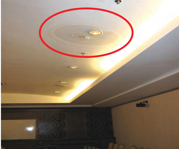
Foto 8.1 Kerosakan Siling Akibat Resapan Air Hujan
