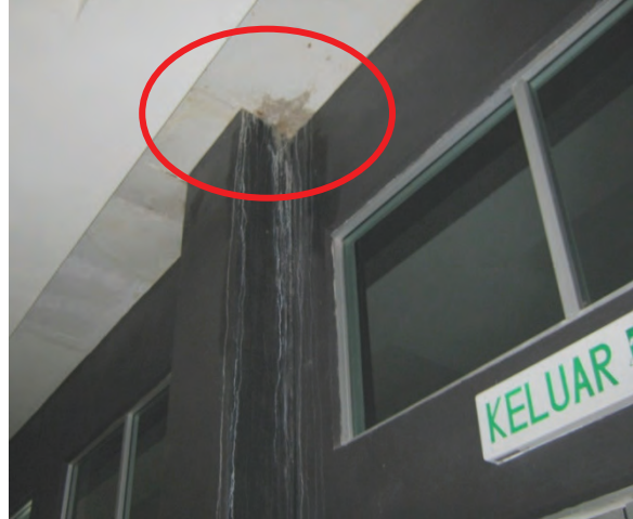
Foto 8.2 Kerosakan Siling Akibat Resapan Air Hujan
