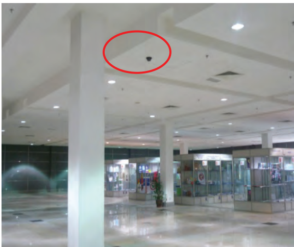
Foto 8.5 Kamera Litar Tertutup Tidak Berfungsi
