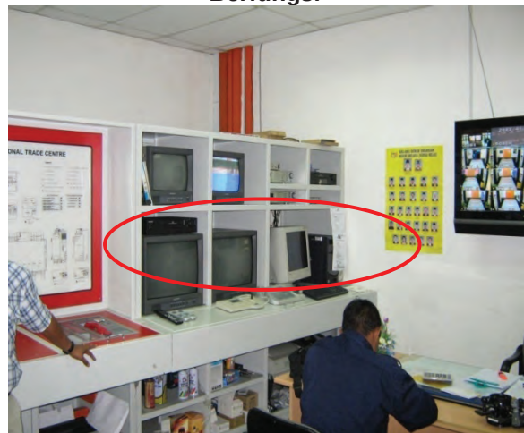
Foto 8.6 Peralatan Kamera Litar Tertutup Tidak Berfungsi
