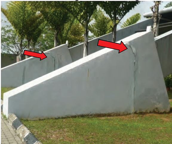
Foto 8.3 Keretakan Bahagian Rusuk Bangunan
