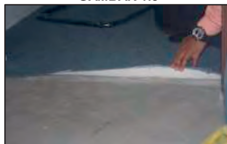
Blok Pentadbiran SMSTG - Lantai Tidak Dipasang Tiles (07.12.2017)
