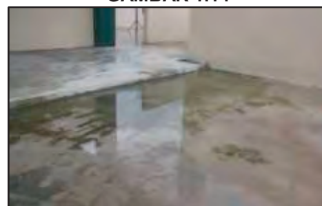
Tingkat 2, Bangunan Asrama SMSTG - Air Bertakung Tidak Mengalir ke Saluran Keluar (28.11.2017)
