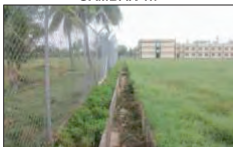
Padang Bola SMSTG - Longkang Dibina Tanpa Penutup (24.12.2017)
