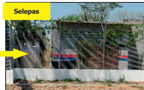
Padang Hoki, Kompleks Sukan Muadzam Shah - Pagar yang Telah Diganti Baharu (24.02.2021) (Sumber: Jabatan Audit Negara)
