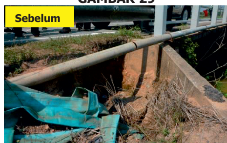
K104 - Kg. Bukit - Tebing Runtuh (9.3.2020) (Sumber: Jabatan Audit Negara)
