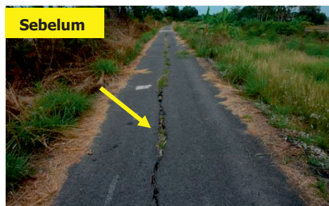
Kg. Pengkalan Kakap, Kuala Muda - Rekahan Pada Permukaan Jalan Yang Diturap (11.03.2020) (Sumber: Jabatan Audit Negara)
