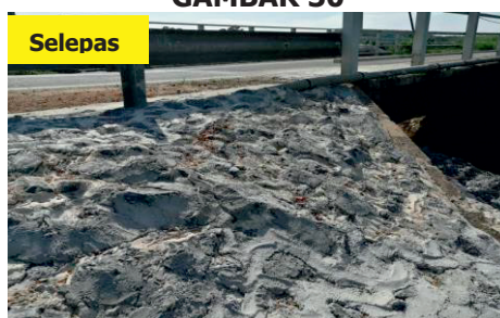
K104 - Kg. Bukit - Tebing Runtuh Telah Diambil Tindakan Pembaikan (6.12.2020) (Sumber: JKR Daerah Kubang Pasu)
