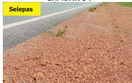
K15 - Jalan Batu 42/Asam Jawa/Parit Panjang - Bahu Jalan Tinggi 9 Inci Telah Diratakan (10.9.2020) (Sumber: JKR Daerah Baling)
