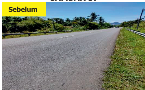
Jalan Batu 42 / Gulau (TEKIH) - Tiada Garisan Tepi (27.2.2020) (Sumber: Jabatan Audit Negara)
