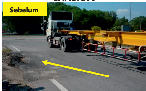
Jalan Perindustrian PKNK, Bukit Kayu Hitam, Kubang Pasu - Jalan Mendap Laluan Kenderaan Berat (09.03.2020) (Sumber: Jabatan Audit Negara)
