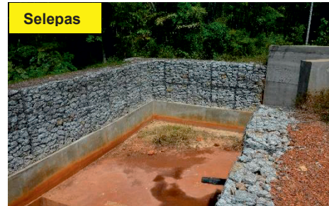
Baik Pulih Tebing Runtuh K722 - Kampung Lahar Parang, Baling (27.2.2020) (Sumber: Jabatan Audit Negara)
