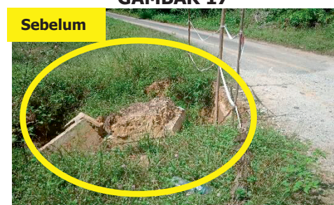
Kg. Sungai Pisang, Padang Terap - Culvert Runtuh (07.03.2020) (Sumber: Jabatan Audit Negara)
