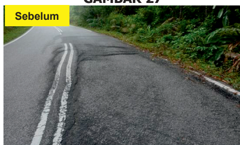
K020 - Jalan Sintok / Padang Sanai - Gelinciran ( Slippage ) pada Pavement (10.3.2020) (Sumber: Jabatan Audit Negara)
