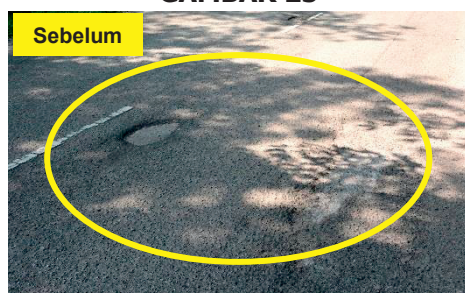
Jalan Kg. Bukit Kecil (K103) - Jalan Berlubang 10.3.2020 (Sumber: Jabatan Audit Negara)
