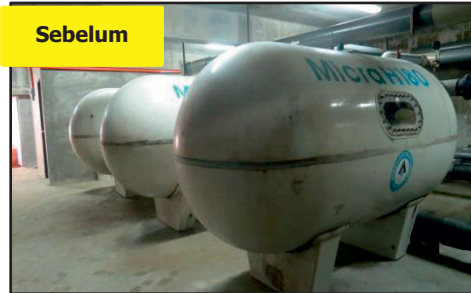
Kompleks Akuatik, Gunung Keriang - Kebocoran Penapis Air (03.03.2020) (Sumber: Jabatan Audit Negara)
