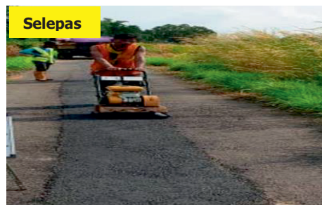
Kg. Pengkalan Kakap, Kuala Muda - Rekahan Pada Permukaan Jalan Telah Dibaiki (01.10.2020) (Sumber: JPS Daerah Kuala Muda)
