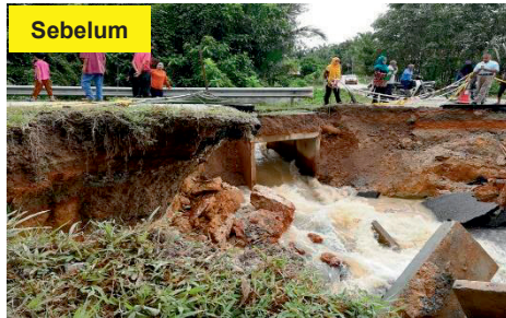
Tebing Runtuh dan Jalan Putus K722 - Kampung Lahar Parang, Baling (21.11.2018) (Sumber: JKR Daerah Baling)
