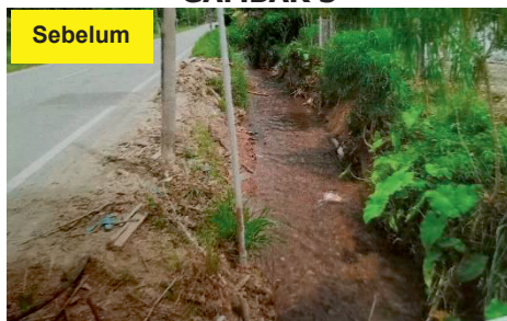
K107 - Kubang Betong (Kubang Pasu) - Aduan Bahu Jalan Runtuh (9.7.2019) (Sumber: JKR Daerah Kubang Pasu)
