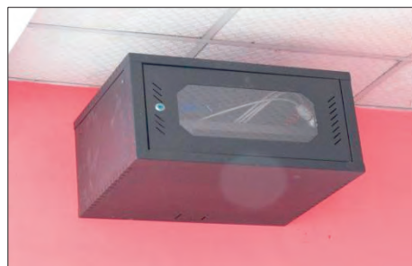
Kolam Renang Taman Ungku Tun Aminah, MBIP - Router yang Tidak Didaftar dan Dilabel (03.07.2019) (Sumber : Jabatan Audit Negara)
