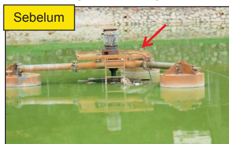
LRK Taman Cempaka (JBBT37) - Surface Aerator Tidak Berfungsi Kerana Tiada Bekalan Elektrik Disebabkan Oleh Vandalisme (09.03.2017)
