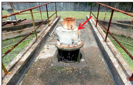
LRK Taman Bukit Kempas (JBBT22) - Mixer Tangki Mendapan Tidak Berfungsi (09.03.2017)
