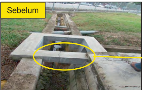
Sebelum Pentas Utama Pintu B, Stadium Sultan Ibrahim - Lepaan Permukaan Longkang Retak (31.10.2017)
