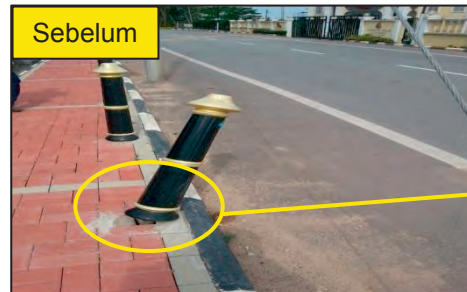
Sebelum Jalan Susur, Bukit Kepong - Bollard Dipasang Longgar/Tidak Kemas (30.10.2017)
