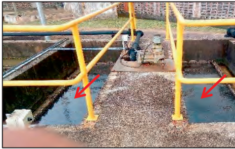
LRK Taman Tampoi Indah Kipmart (JBBT33) - Septicity (Efluen berwarna hitam) di Tangki Mendapan (09.03.2017)
