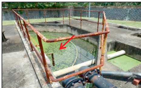
LRK Taman Bukit Kempas (JBBT22) - Tangki Mendapan Tidak Berfungsi (09.03.2017)
