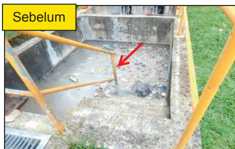
LRK Taman Cempaka (JBBT37) - Incoming Chamber Tidak Berfungsi Kerana Tiada Bekalan Elektrik Disebabkan Oleh Vandalisme (09.03.2017)
