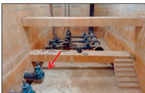
LRK Taman Daya (JBU96) - Dua (2) Daripada Tiga Raw Sewage Pump Tidak Beroperasi (09.03 2017)
