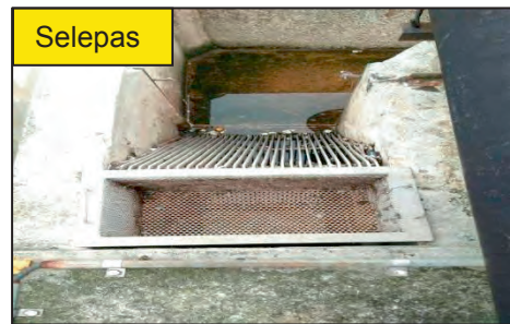
LRK Taman Kempas Indah (JBU114) - Incoming Screen Chamber Kotor dan Berlumut Telah Dibersihkan (Ogos 2017) Sumber: MJB
