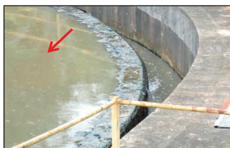
LRK Taman Daya (JBU96) - Scum Tidak Dapat Dibersihkan Kerana Pam dan Scraper Tidak Berfungsi (09.03.2017)
