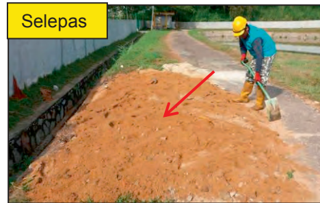
LRK Taman Cempaka (JBBT37) - Mendapan Tanah Telah Dibaiki (Julai 2017) Sumber: MBJB
