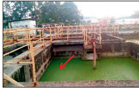
LRK Taman Tampoi Indah Kipmart (JBBT33) - Tangki Rawatan Dipenuhi Algae (09.03.2017)
