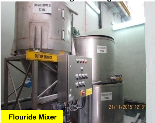
Gambar 3.11 Peralatan Yang Tidak Digunakan
