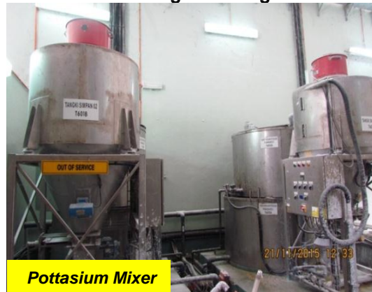
Gambar 3.10 Peralatan Yang Tidak Digunakan
