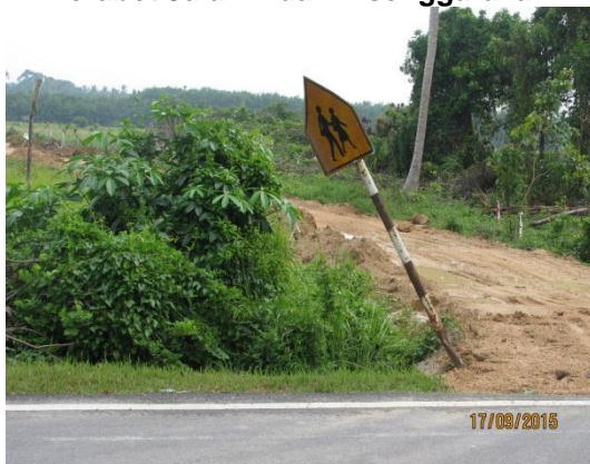
Perabot Jalan Tidak Disenggarakan
