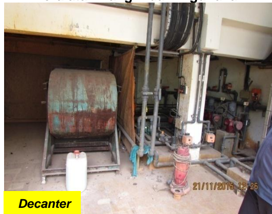
Gambar 3.12 Peralatan Yang Tidak Digunakan
