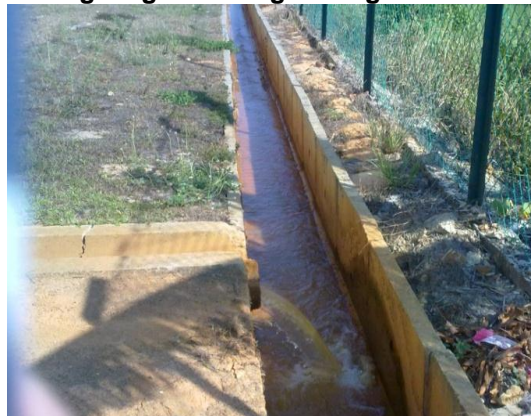
Gambar 3.19 Pembuangan Sisa Enap Cemar ke dalam Longkang dan Sungai Pengkalan Datu
