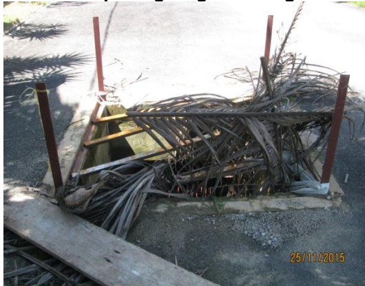
Gambar 1.13 Penutup Longkang Tidak Diganti
