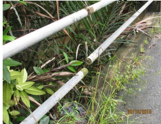
Gambar 1.14 Pagar Jambatan Tidak Disenggarakan
