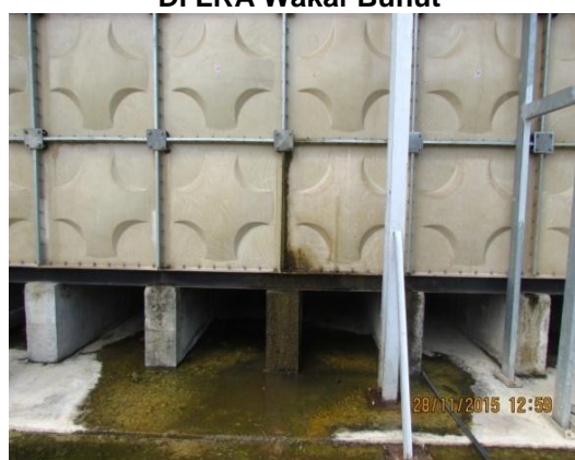
Gambar 3.6 Kebocoran di Tangki UF Di LRA Wakaf Bunut
