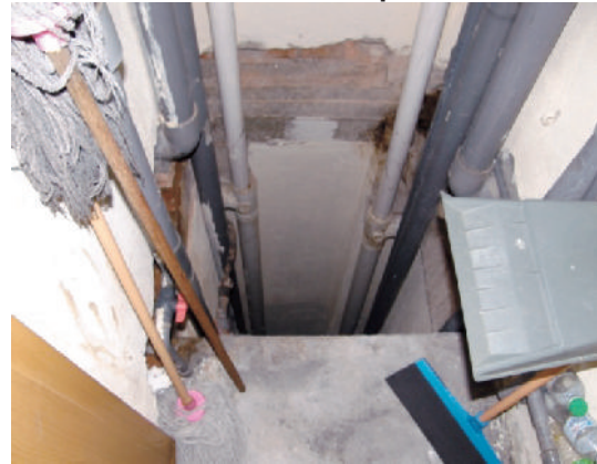
Gambar 2.4 Bilik Servis – Ruang Laluan Paip Servis Tidak Ditutup
