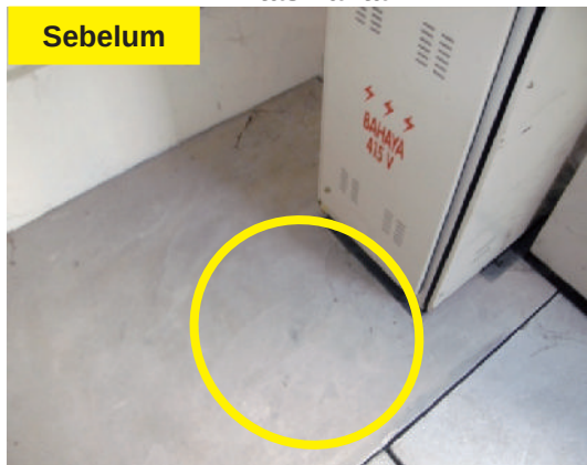
Gambar 2.9 Tiada Pelapik Getah Diletakkan Di Atas Lantai
