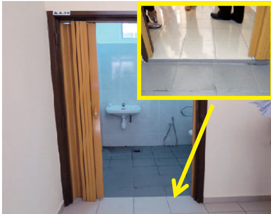
Gambar 2.3 Laluan Ramp Tidak Disediakan Di Tandas OKU
