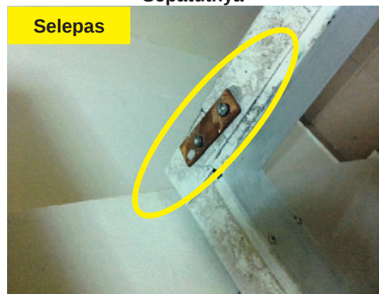
Gambar 2.20 Pemasangan Copper Bridge Yang Sepatutnya
