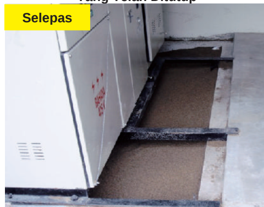
Gambar 2.8 Parit Laluan Kabel Di Bilik MSB Yang Telah Ditutup
