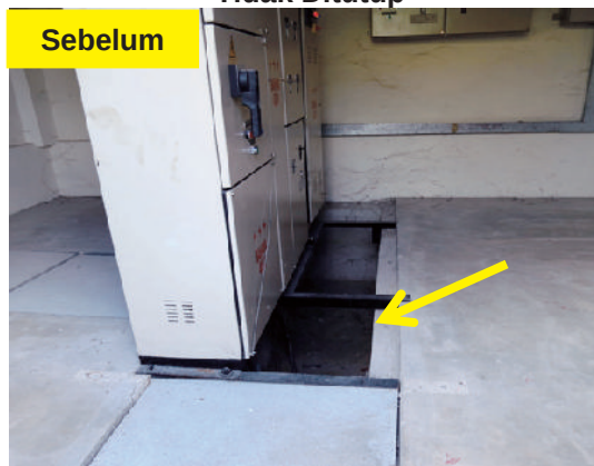
Gambar 2.7 Parit Laluan Kabel Di Bilik MSB Tidak Ditutup
