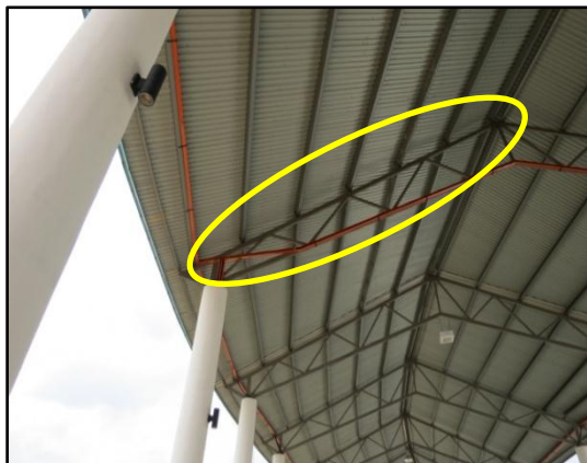
GAMBAR 8.47 Trunking Elektrik Tidak Ditutup Sepenuhnya. Penebat Kabel Yang Terdedah Mudah Rosak Dan Mengurangkan Jangka Hayat Kabel
