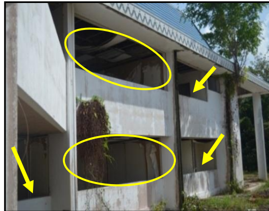
GAMBAR 5.24 Bingkai Besi Dan Tingkap Yang Hilang Dan Dicuri
