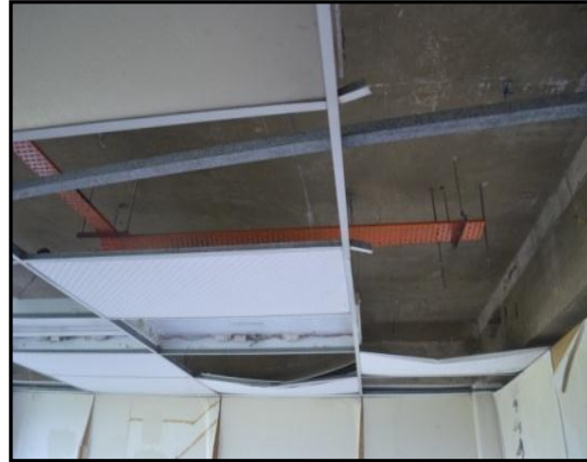
GAMBAR 5.22 Siling Yang Dirosakkan Untuk Mencuri Kabel Elektrik
