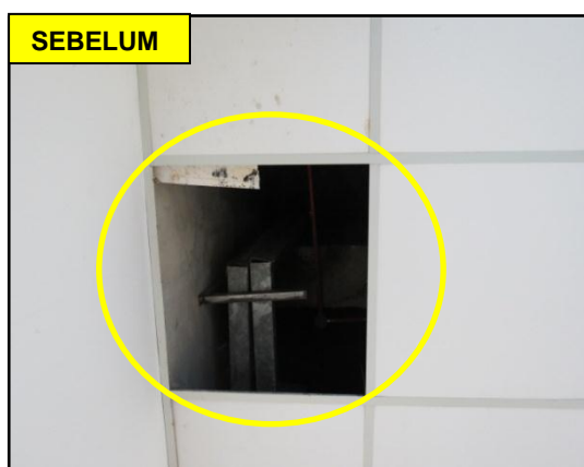
GAMBAR 8.1 Terdapat Bukaan Pada Binaan Siling Gantung
