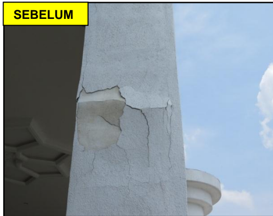
GAMBAR 8.3 Keretakan Pada Permukaan Kemasn Penutup Tiang
