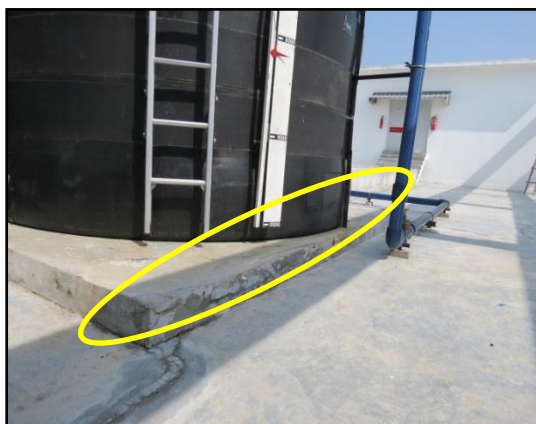
GAMBAR 8.14 Keretakan Pada Permukaan Tepi Concrete Plinth Tangki Air
