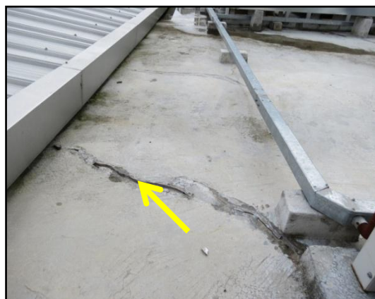
GAMBAR 8.15 Terdapat Keretakan Di Permukaan Lantai Bumbung Rata
