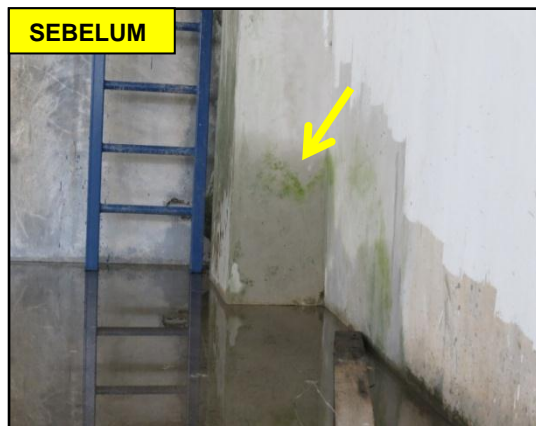
GAMBAR 8.18 Kesan Resapan Air Dan Pertumbuhan Kulat Pada Permukaan Dinding
