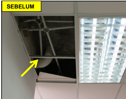
GAMBAR 8.20 Bukaan Pada Siling Gantung Disebabkan Kebocoran Paip Di Atas Siling
