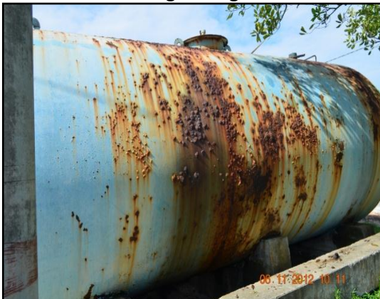
GAMBAR 2.17 Skid Tank Yang Usang Dan Bocor
