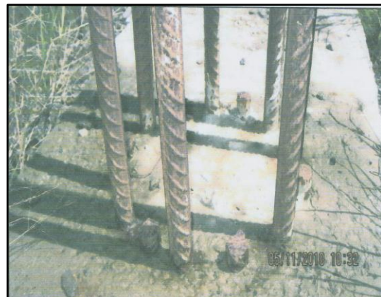
GAMBAR 3.17 Nos Keluli Pile Cap Berbeza Dengan Lukisan Pembinaan
