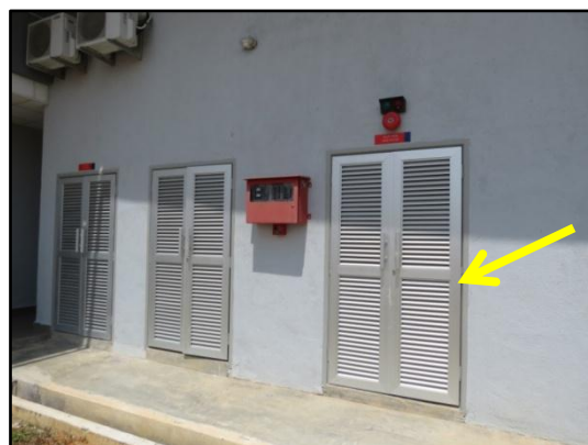
GAMBAR 8.52 Notis DILARANG MASUK, BAHAYA Dan DILARANG MEROKOK Tidak Dilekatkan Pada Setiap Pintu Bilik Suis
