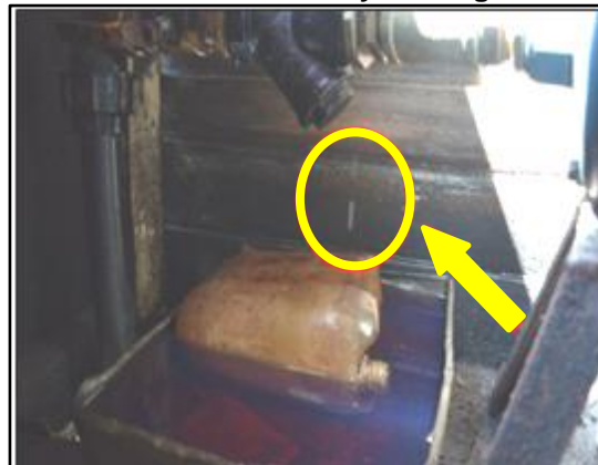
GAMBAR 2.18 Kebocoran Pada Penyambung Hos
