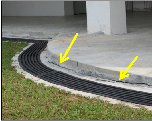
GAMBAR 8.9 Terdapat Keretakan Di Antara Apron Dan Longkang Perimeter Bangunan
