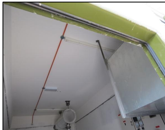
GAMBAR 8.48 Setiap Bilik Suis Tidak Dilengkapi Dengan Alat Pengesan Kebakaran Dan Alat Pemadam Api
