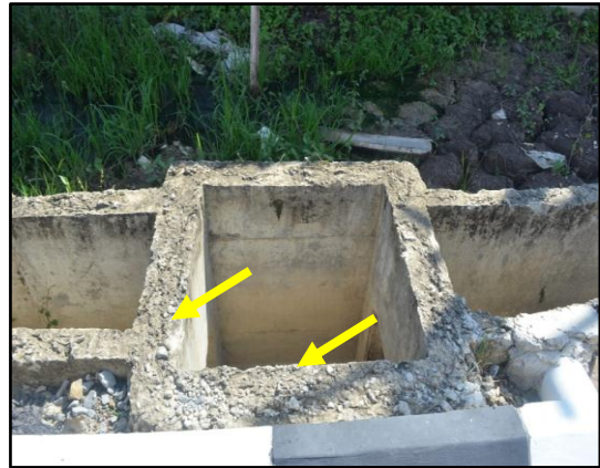
GAMBAR 3.38 Kualiti Kerja Pembinaan Longkang Dan Sump Yang Tidak Kemas
