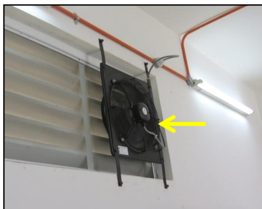
Lokasi: Ruang Switchgear , Masjid Tarikh: 16 Oktober 2012
