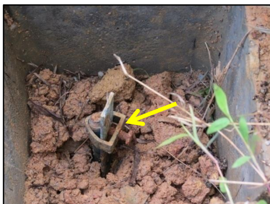
GAMBAR 8.51 Penyambungan Pada Earth Electrode Tidak Menggunakan Kaedah Exothermic Welding
