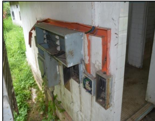
GAMBAR 5.8 Kotak Suis Yang Telah Rosak Dan Tidak Berfungsi
