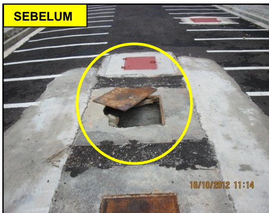
GAMBAR 6.9 Kedudukan Pembinaan Lurang Yang Tidak Sesuai Di Kawasan Parkir Motosikal Dan Bahagian Tepi Lurang Telah Disimen
