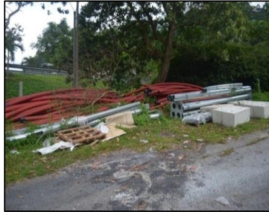
GAMBAR 5.10 Tiang Lampu Dan Kabel Yang Diletakkan Di Dalam Kawasan LLM
