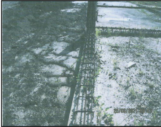
GAMBAR 3.18 Tiada Started Steel Bar Dipasang Pada Ground Slab
