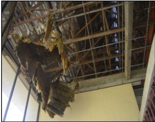
GAMBAR 5.19 Siling Bumbung Yang Rosak
