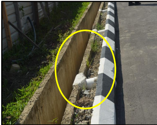
GAMBAR 3.35 Bahagian Belakang Kerb Yang Tidak Sempurna
