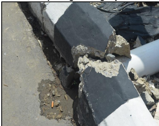
GAMBAR 3.39 Kerb Yang Telah Dipasang Pecah Akibat Kerja Lanskap Yang Sedang Dijalankan
