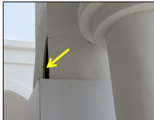
GAMBAR 8.8 Tiang Ditutup Dengan Kepingan Papan - Kemasn Tiang Yang Tidak Sesuai
