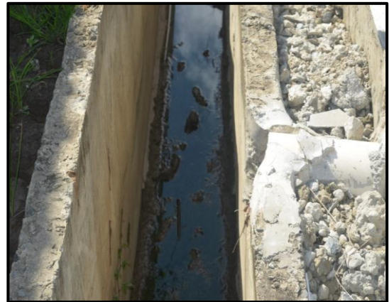
GAMBAR 3.36 Bahagian Belakang Kerb Yang Tidak Sempurna
