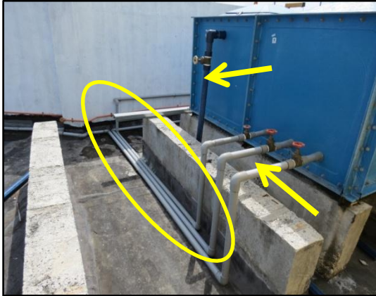
GAMBAR 8.43 Tiada Besi Penyokong Dipasang Di Paip Air Dan Penggunaan 2 Paip Yang Berlainan Jenis Pada Tangki Air
