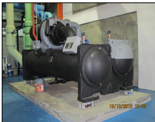
GAMBAR 6.13 Kegagalan Chiller Ini Berfungsi Menyebabkan Penyaman Udara Sepusat Bagi Perpustakaan Sering Terganggu
