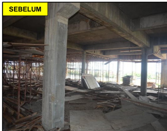
GAMBAR 3.33 Housekeeping Di Dalam Bangunan Yang Tidak Kemas
