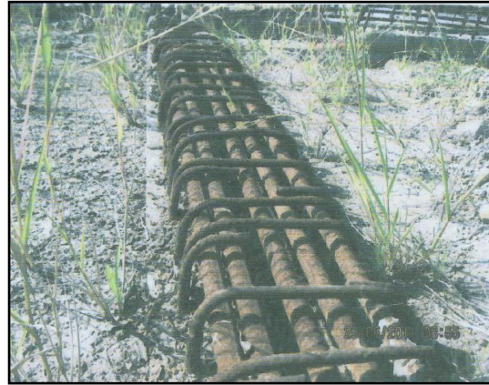
GAMBAR 3.19 Rod Keluli Untuk Ground Beam Telah Berkarat
