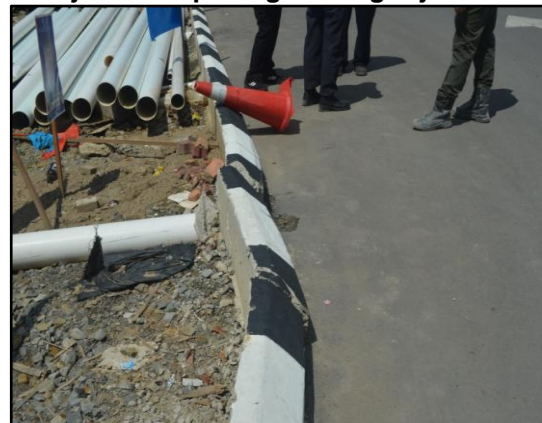
GAMBAR 3.40 Kerb Yang Telah Dipasang Pecah Akibat Kerja Lanskap Yang Sedang Dijalankan
