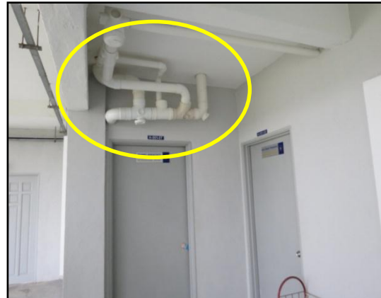
GAMBAR 8.35 Saluran Paip Servis Berada Di Atas Pintu Dan Tidak Ditutup (Box Up)
