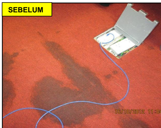
GAMBAR 6.7 Resapan Air Membasahi Lantai Dan Air Bertakung Di Dalam Soket Elektrik
