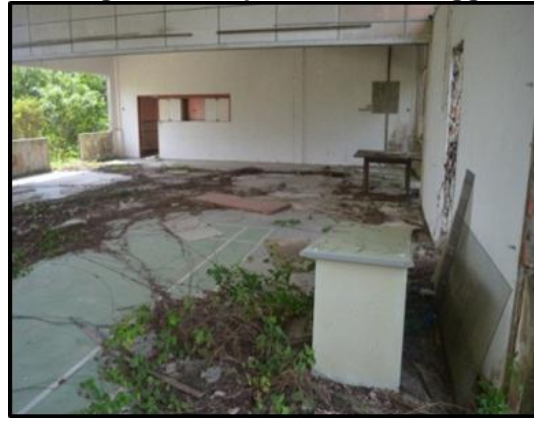
GAMBAR 5.16 Ruang Dalam Depoh Tidak Disenggara
