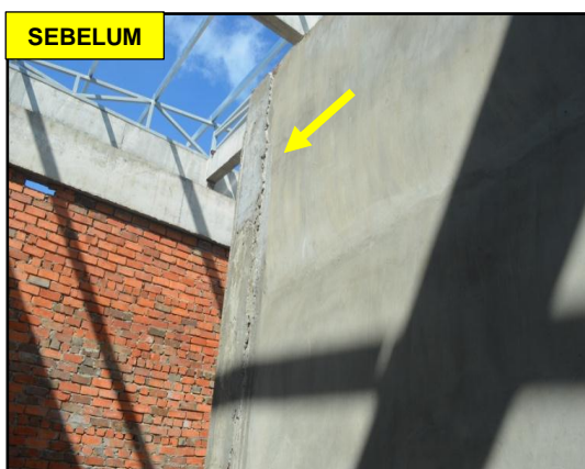
GAMBAR 3.27 Kerja Lepaan Dinding Yang Tidak Kemas
