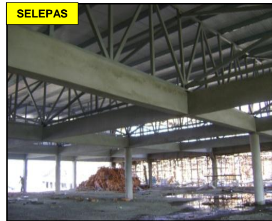
GAMBAR 3.30 Rasuk Konkrit Yang Telah Dibaiki
