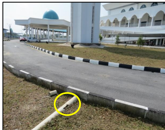
GAMBAR 8.37 Saluran Penyambungan Tidak Ditanam Di Dalam Tanah Dan Telah Pecah
