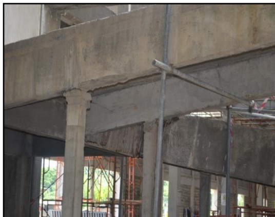
GAMBAR 3.23 Kualiti Pembinaan Tiang Konkrit Tidak Memuaskan
