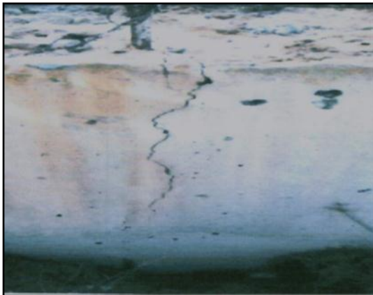
GAMBAR 3.14 Keretakan Pada Ground Beam
