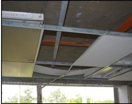
GAMBAR 5.21 Siling Yang Dirosakkan Untuk Mencuri Kabel Elektrik
