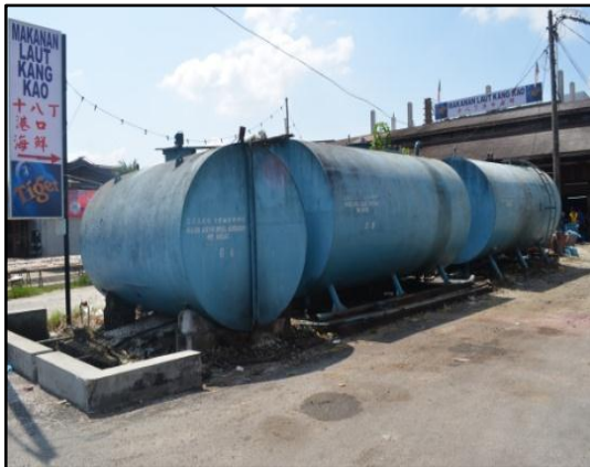
GAMBAR 2.10 Skid Tank Tidak Berpagar
