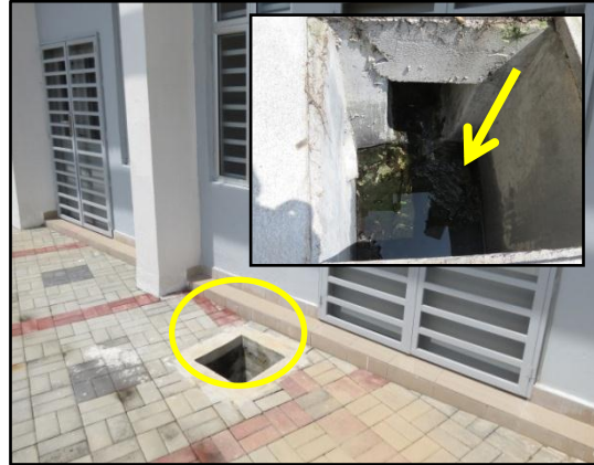
GAMBAR 8.44 Lurang Tidak Ditutup Dan Air Kumbahan Tidak Mengalir
