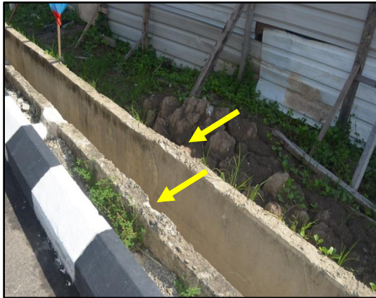
GAMBAR 3.37 Kualiti Kerja Pembinaan Longkang Dan Sump Yang Tidak Kemas
