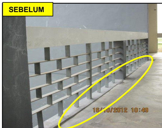
GAMBAR 6.11 Pembinaan Scupper Drain Yang Tiada Aras Kedalaman
