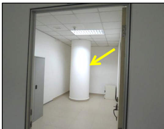
Lokasi: Bilik Fail 1, Masjid Tarikh: 16 Oktober 2012
