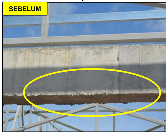
GAMBAR 3.29 Pemadatan Rasuk Konkrit Yang Tidak Sempurna
