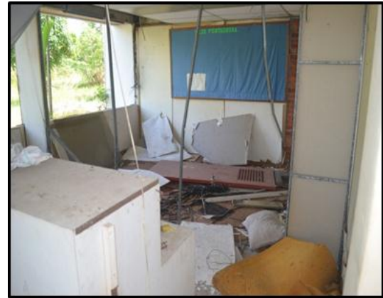
GAMBAR 5.20 Ruang Dalam Bangunan Yang Rosak
