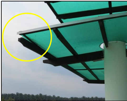
GAMBAR 8.5 Pemasangan Timber Pagola Yang Tidak Sempurna
