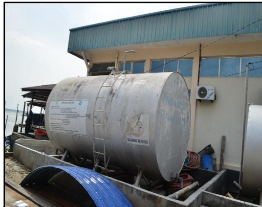
GAMBAR 2.11 Skid Tank Tidak Berpagar
