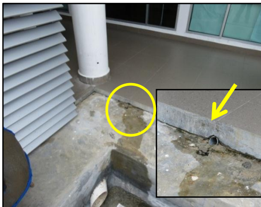
GAMBAR 8.36 Pemasangan Saluran Paip Air Tidak Dipasang Terus Ke Longkang Perimeter Bangunan
