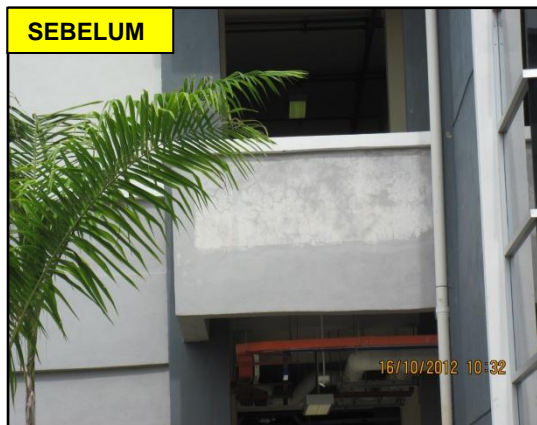
GAMBAR 6.5 Cat Pudar Dan Tidak Kemas Walaupun Bangunan Baru Disiapkan Pada Bulan Mac 2012
