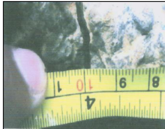
GAMBAR 3.15 Keretakan Pada Ground Beam
