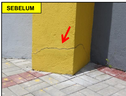
GAMBAR 8.24 Keretakan Pada Struktur Tiang
