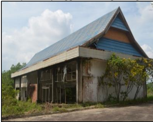
GAMBAR 5.15 Depoh Penyenggaraan Yang Usang
