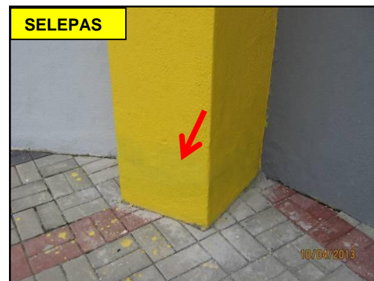
GAMBAR 8.25 Keretakan Pada Struktur Tiang Telah Dibaiki
