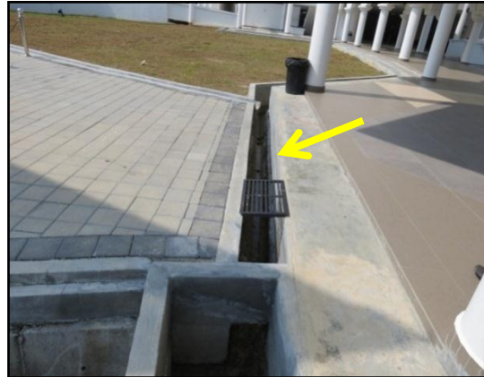
GAMBAR 8.39 Longkang Perimeter Tidak Ditutup Sepenuhnya Dan Boleh Mendatangkan Bahaya Kepada Pengguna
