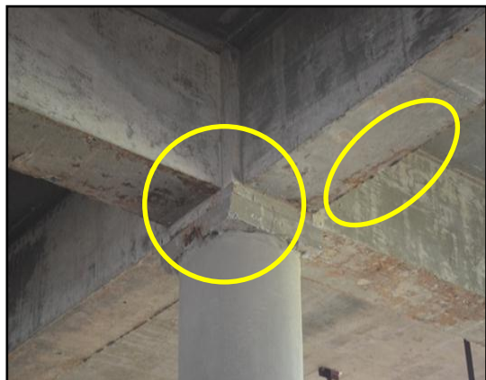
GAMBAR 3.24 Kualiti Pembinaan Tiang Konkrit Tidak Memuaskan
