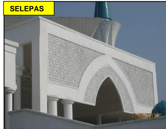
GAMBAR 8.4 Keretakan Pada Permukaan Kemasn Penutup Tiang Telah Dibaiki
