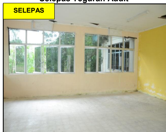
GAMBAR 13.22 Ruang Lobi Rumah Kelab Digunakan Bagi Program Building Operation Selepas Teguran Audit
