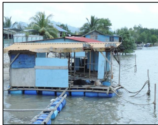
GAMBAR 2.6 Rumah Sangkar Ikan Yang Rosak Akibat Ribut
