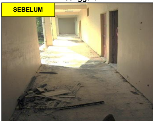
GAMBAR 13.23 Laluan Koridor Ke Bilik Penginapan Tidak Disenggara
