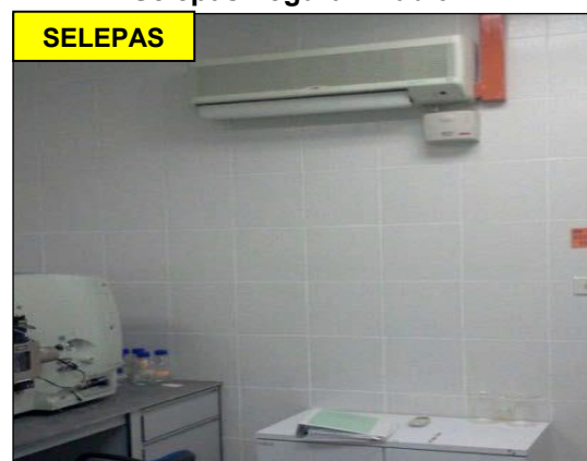
GAMBAR 4.11 Penyaman Udara Telah Digunakan Selepas Teguran Audit
