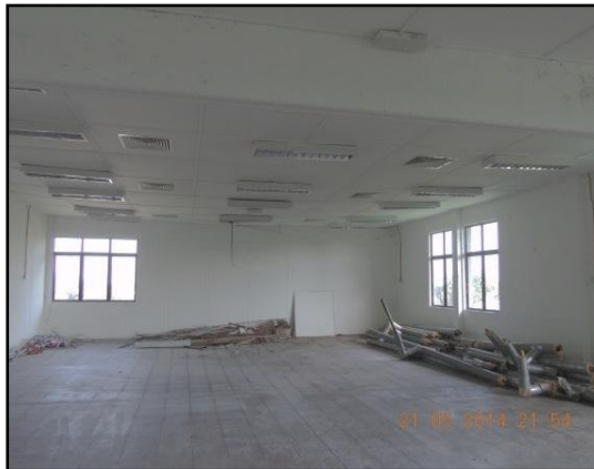
GAMBAR 13.27 Siling Bilik Kuliah Rosak dan Tidak Mempunyai Penyaman Udara
