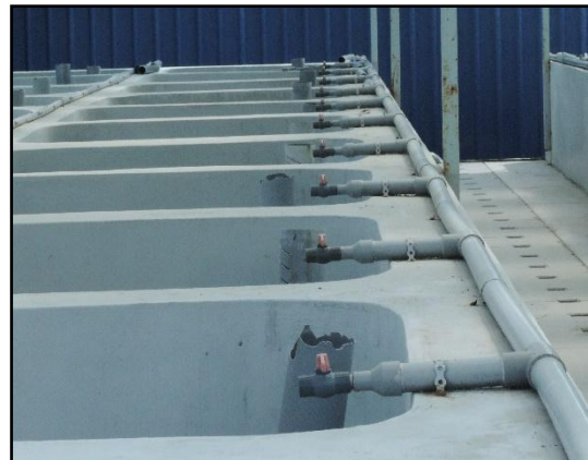
GAMBAR 2.25 Tangki Asuhan Yang Tidak Digunakan
