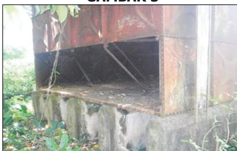
Kampung Baru Pantai, Negeri Sembilan - Aset Tangki Air Terlupus (18.12.2020) (Sumber: PAAB)
